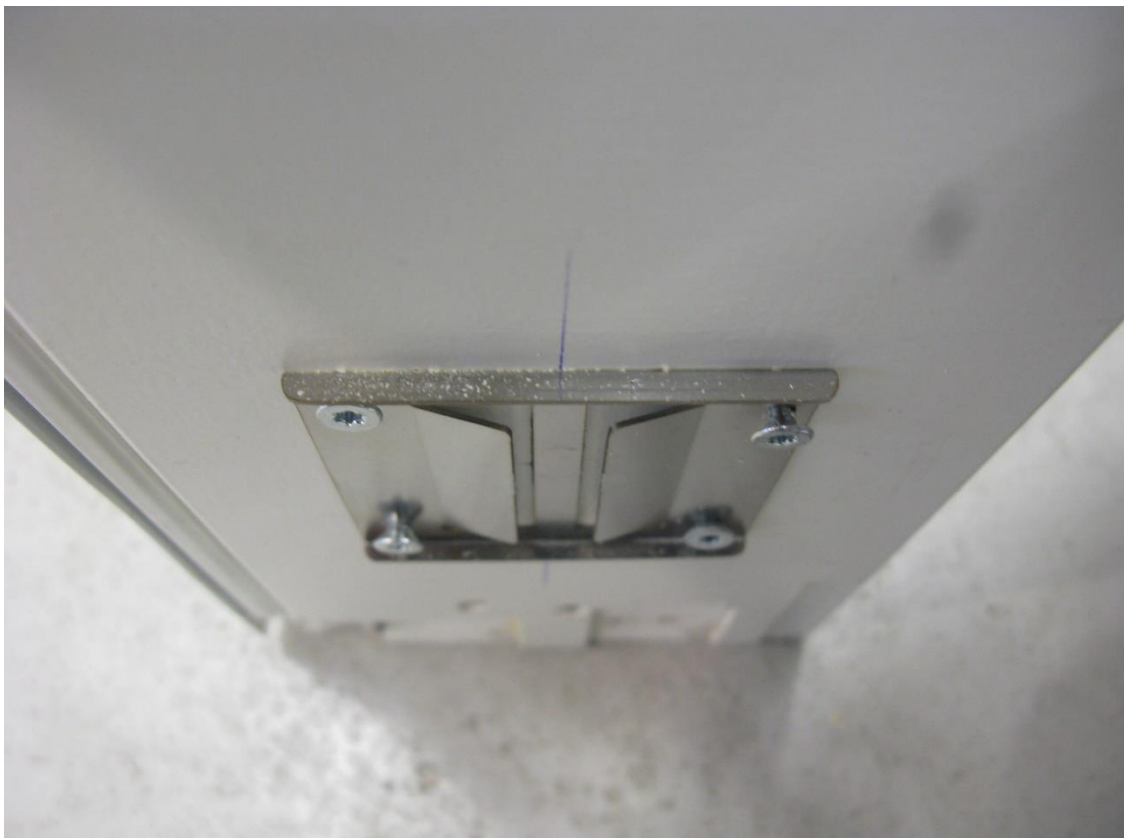
Bild 8: Inga skador noterades på fästena efter provningen.
