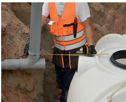
Tee liitokset huolellisesti.
