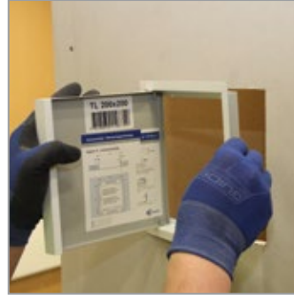
3 Asenna luukku paikalleen aukkoon.
