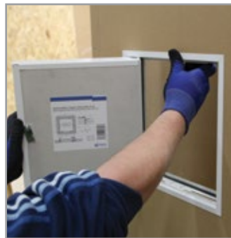
3 Asenna luukku paikalleen aukkoon.
