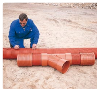
6. Aikaisemmin rakennettuun linjaan tehdään haaroitus haarayhteen, kahden putkenpätkän ja niiden päälle työnnettyjen pistoyhteiden avulla. Yhdistelmän pituinen osa viemäristä sahataan pois, haaroitus asennetaan sen tilalle, ja pistoyhteet keskitetään saumakohtien päälle.
