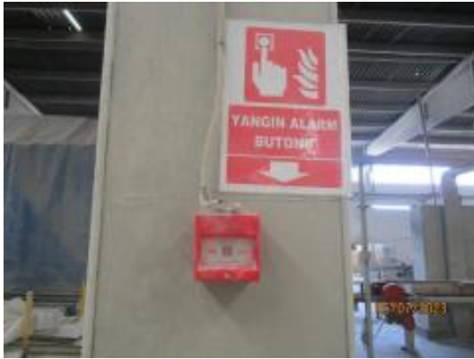
Fire Alarm Button.jpg
